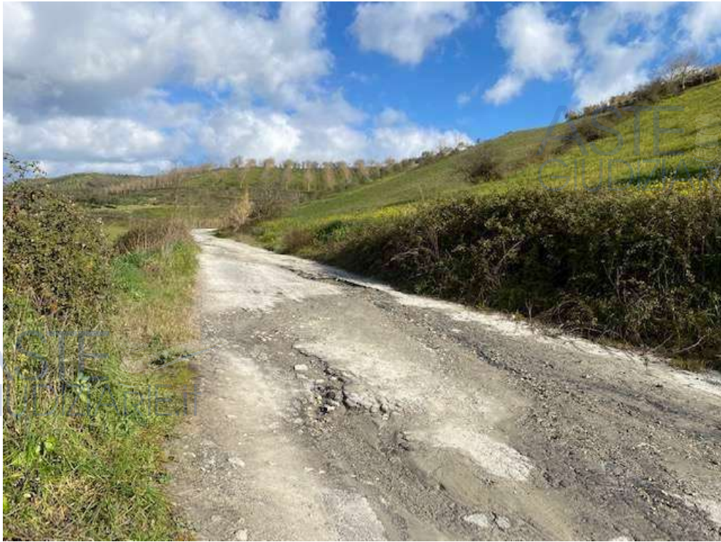
In evidenza strada provinciale dissestata
