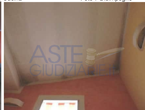
Foto 10 Muffe sul soffitto del vano scale
