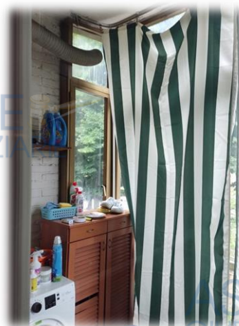
balcone verandato abusivamente
