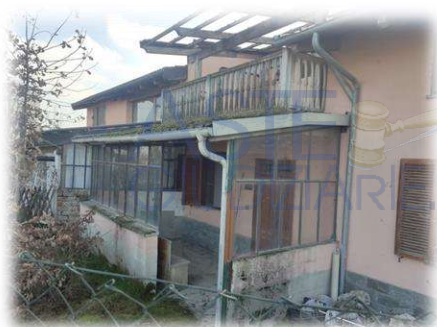
Ingresso attraverso portico verandato abusivamente
