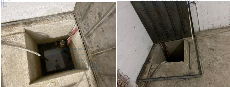
DETTAGLIO POZZO E POMPA AL PIANO INTERRATO
