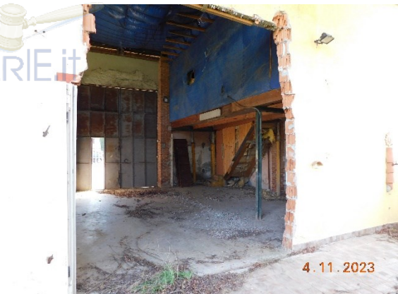
figura - vista corpo di fabbrica ex tettoia e porzione sopalcata realizzata in assenza di titolo edilizio
