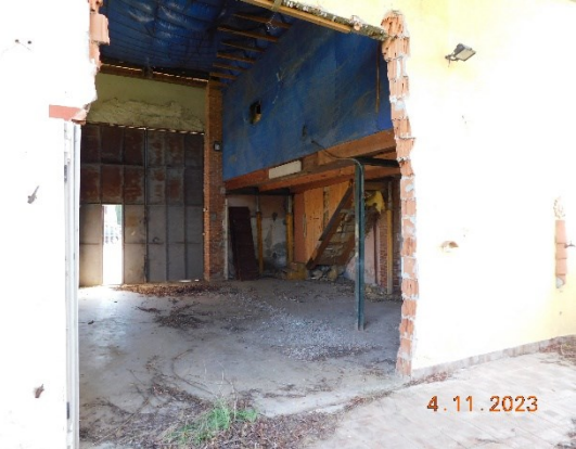
figura - vista corpo di fabbrica ex tettoia e porzione soppalcata realizzata in assenza di titolo edilizio
