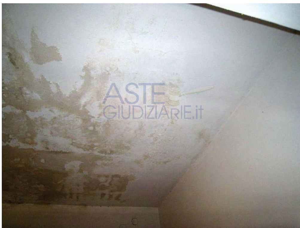
Foto n. 21. Il tetto della lavanderia è in cattive condizioni.
