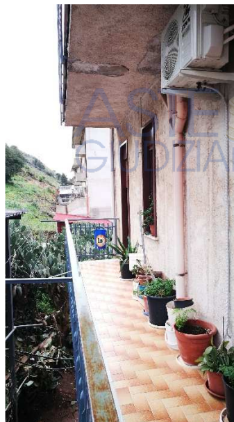
Intradosso balcone - segni di ammaloramento
