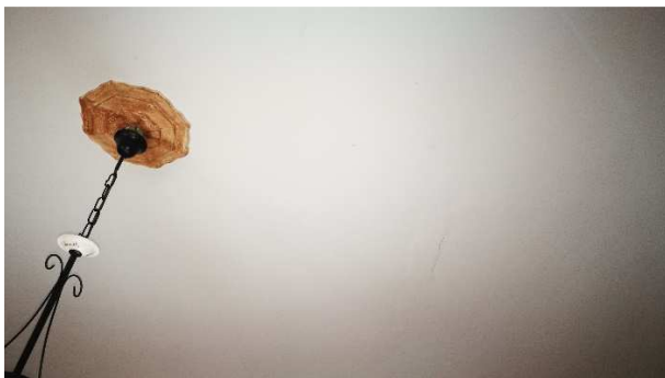
Soffitto cucina - primi segni di sfondellamento
