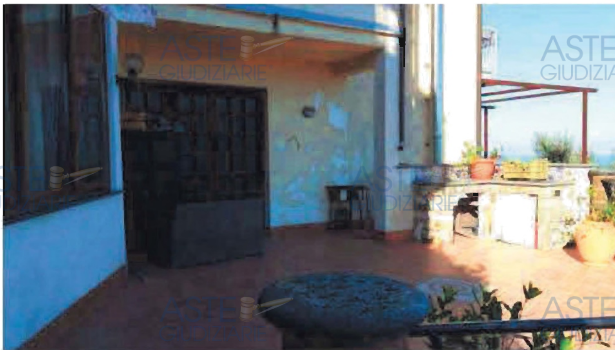
Porzione di terrazzo oggetto di condono
