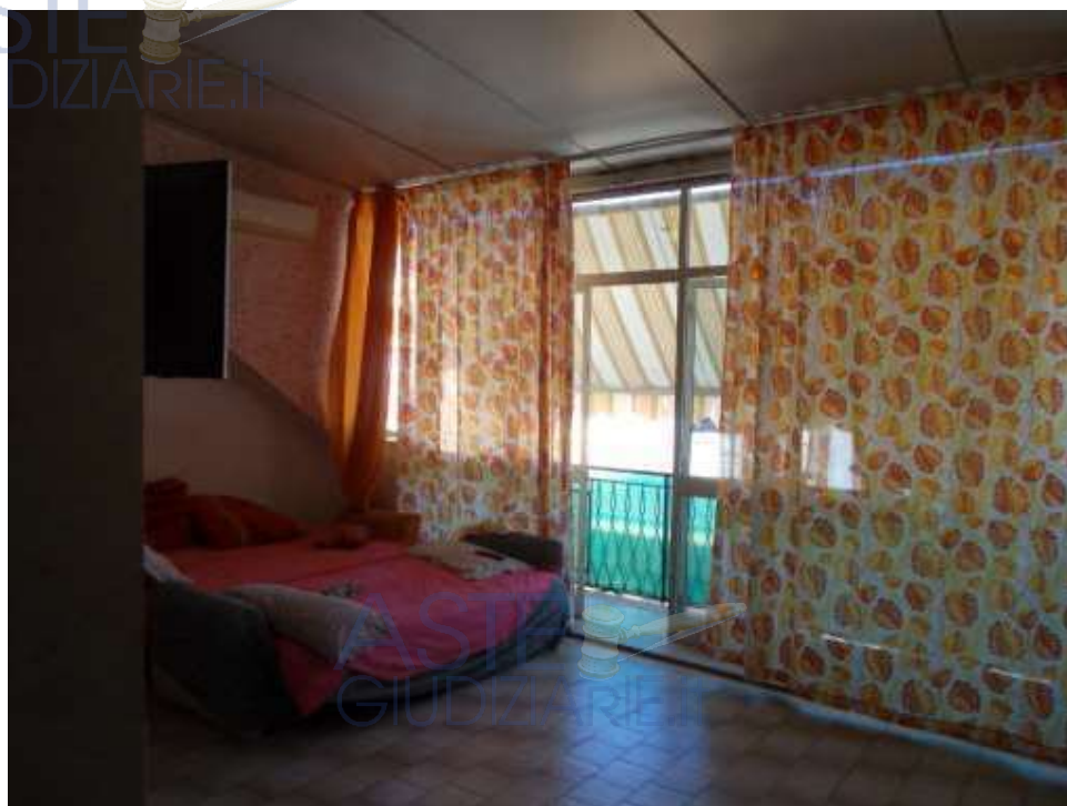
Foto 6 – Immobile “1A” – Chiusura terrazza lato Sud con strutture precarie
