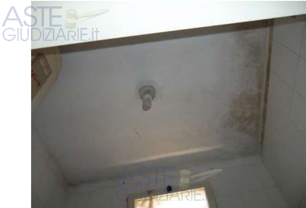
Foto 17 – Immobile “1A” – Segni di umidità nel doppio servizio
