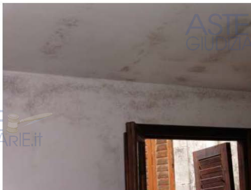
Foto 11 – Appartamento 6A – Presenza di condensa nella camera
