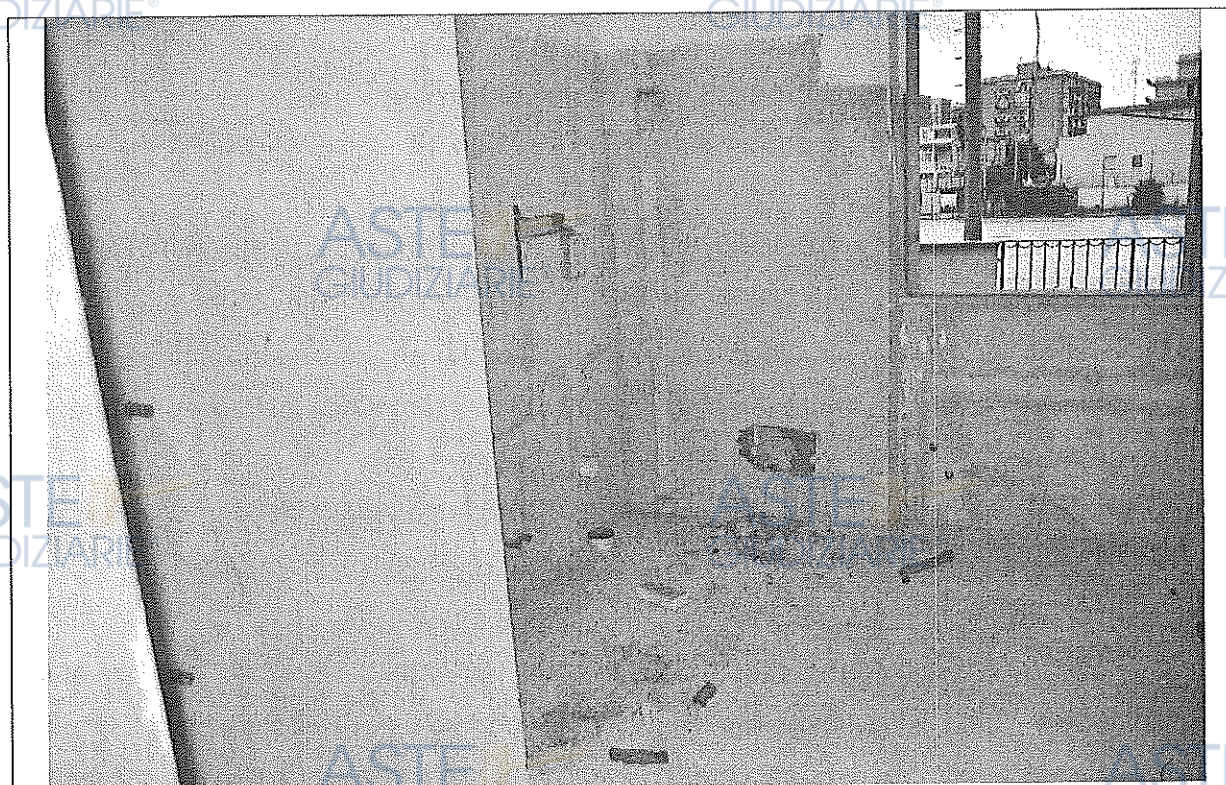
Foto n. 37 – Servizio igienico privo di sanitari
