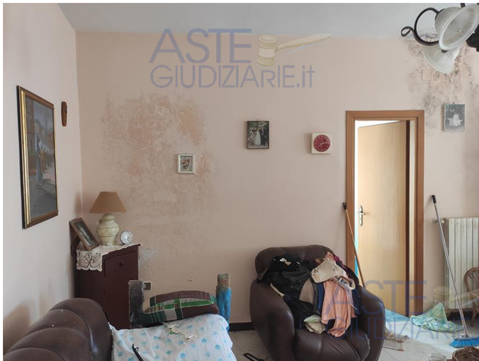
Soggiorno (macchie di infiltrazione)
