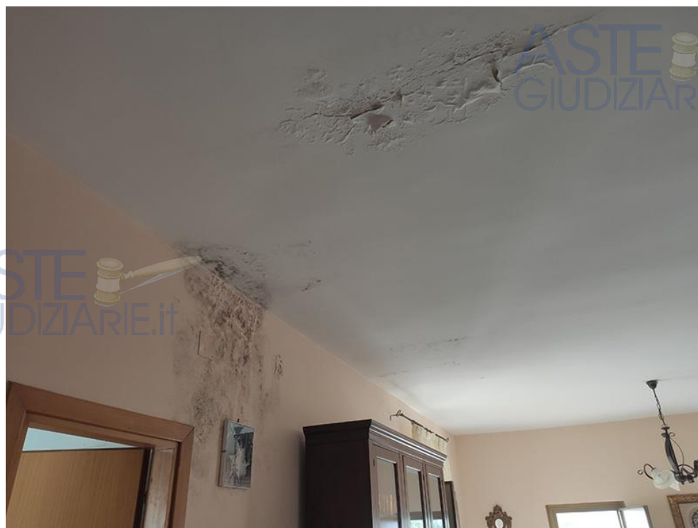
Soggiorno (macchie di infiltrazione)
