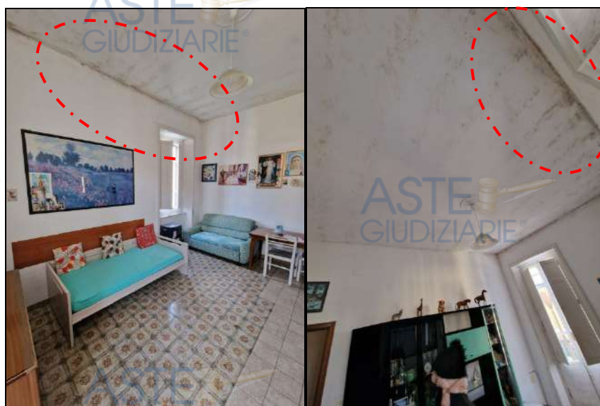
Foto 8-9: viste degli interni del LOTTO UNO (Appartamento al Piano Terzo Sub. 12), in particolare del soggiorno , dotato di doppio affaccio finestrato. Si notino tracce di infiltrazioni presenti nel vano , sia sugli angoli perimetrali che in prossimità degli infissi .
