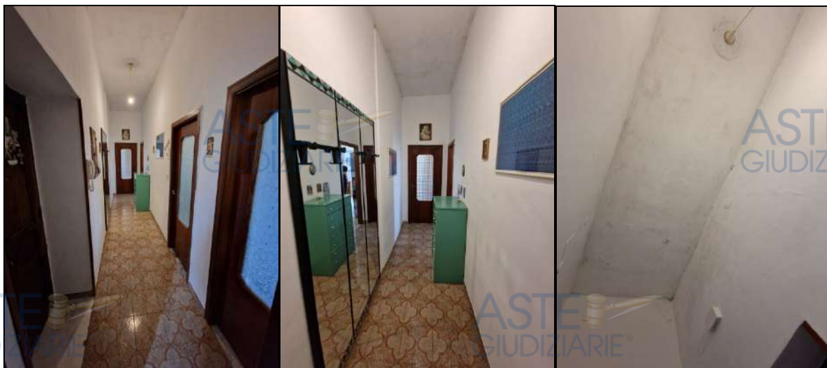
Foto 5-6-7: viste degli interni del LOTTO UNO (Appartamento al Piano Terzo Sub. 12), in particolare del disimpegno di accesso ai vani dell'abitazione. Si notino tracce di infiltrazioni presenti sul soffitto .
