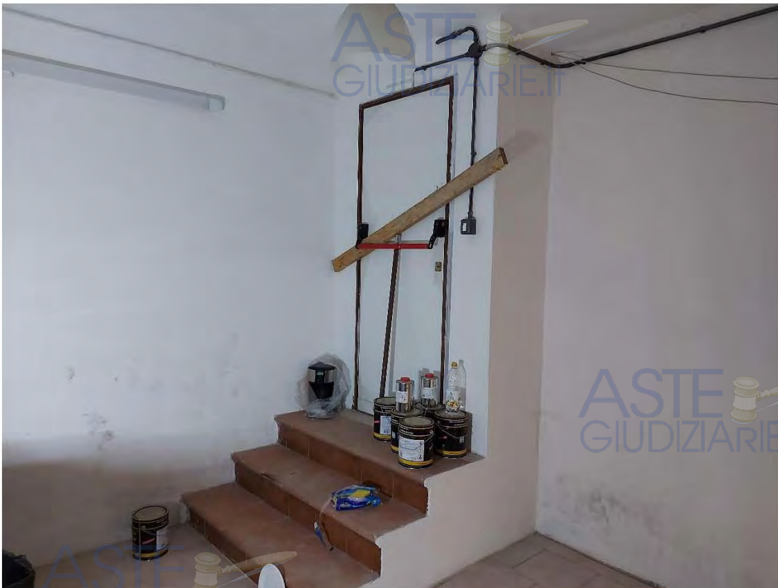
Accesso dal locale "H" a scala con sbarco androne condominiale scala su Via Ciro Menotti
