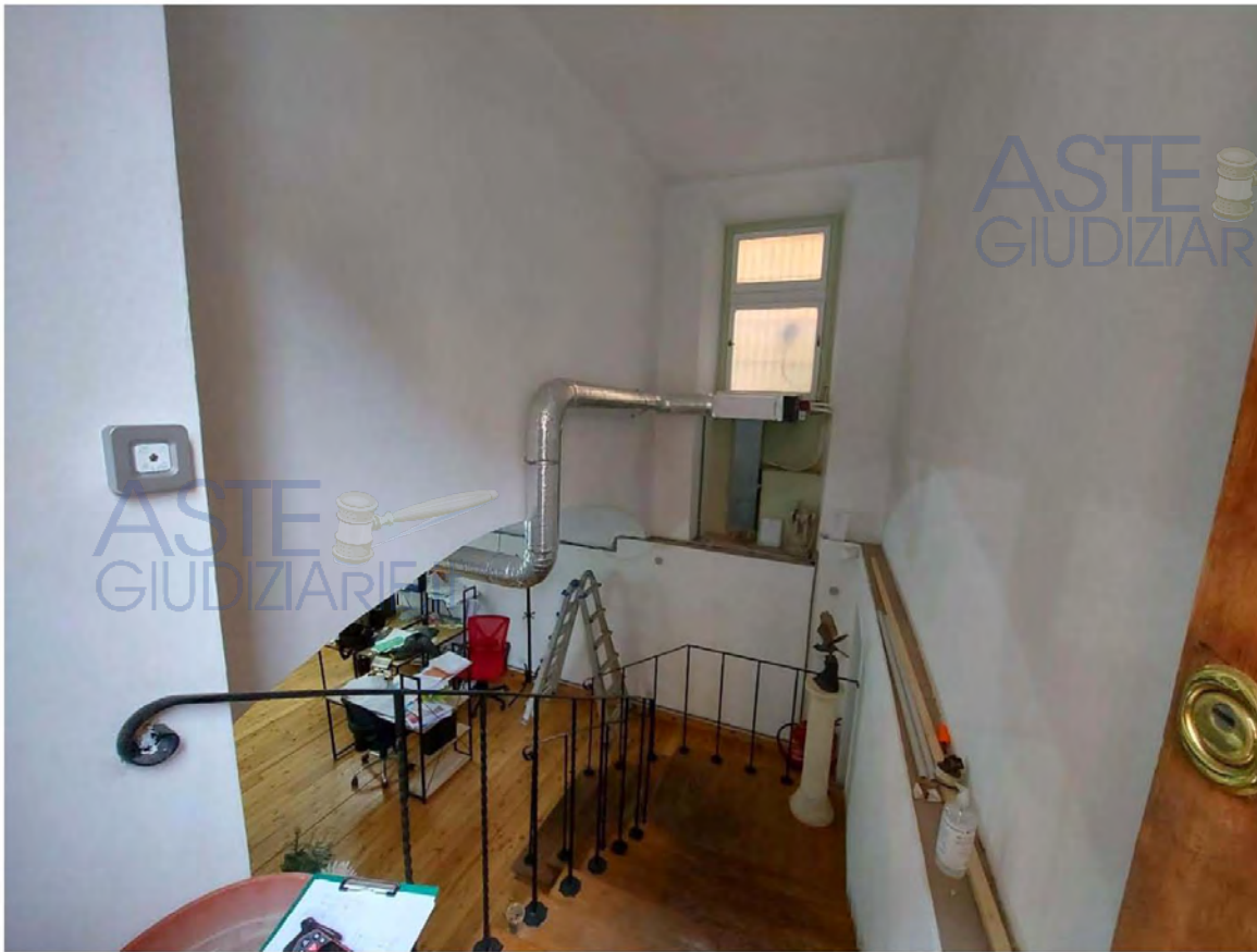
Scala realizzata con demolizione solaio per accesso al piano S1 dal civico 25 – si nota la finestra che in precedenza aveva il servizio igienico
