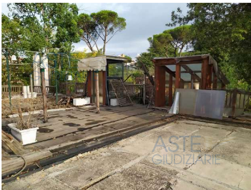
Lo stato di manutenzione della terrazza sovrastante l'ingresso al piano terra del ristorante in data antecedente al deposito dell'elaborato peritale
