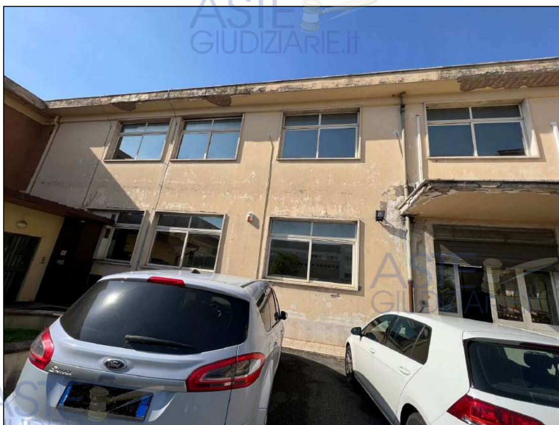
Stato conservativo della facciata con vista dalla corte antistante l'edificio
