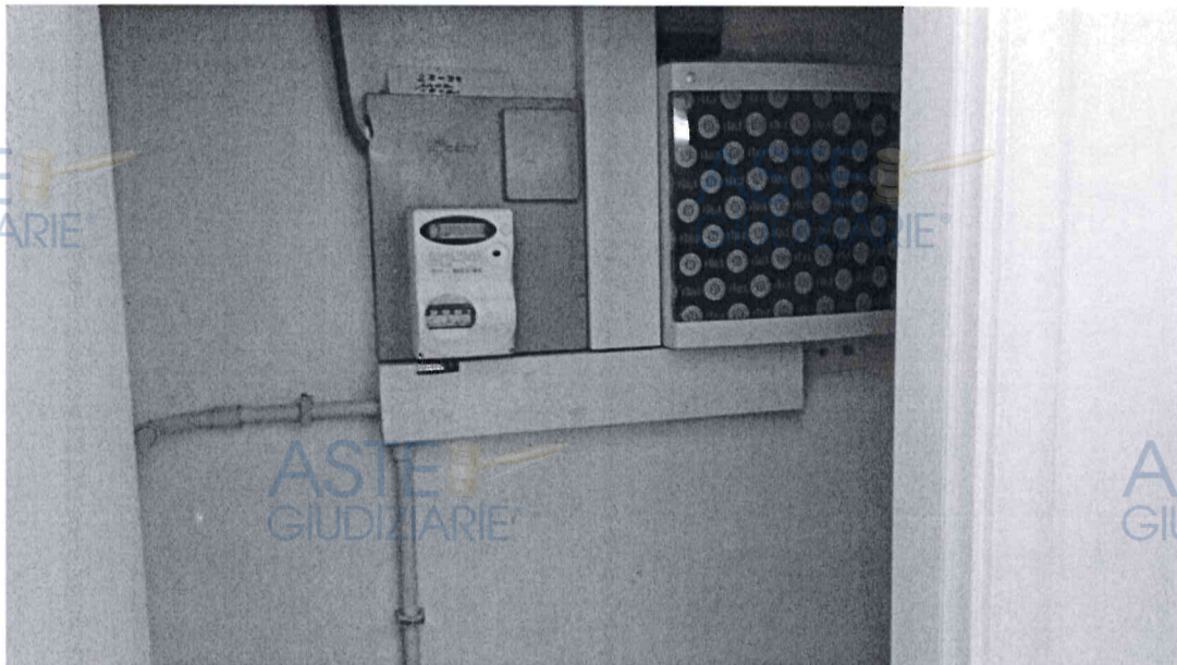
foto n°6 - contatore distribuzione corrente elettrica e quadro elettrico locale commerciale
