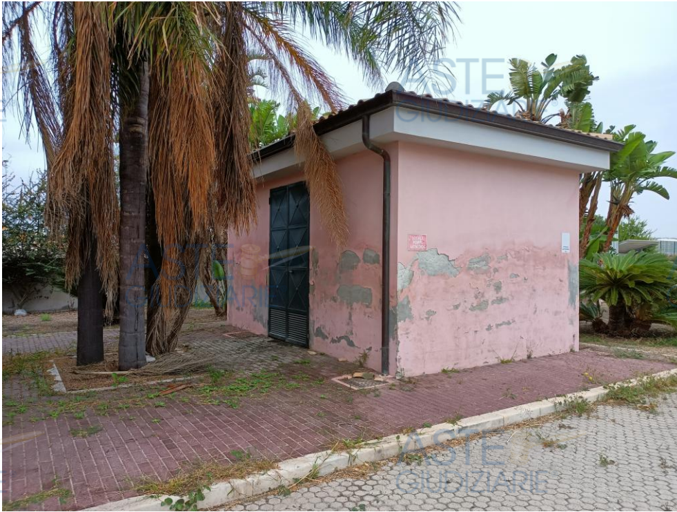
Foto n. 57 – Corpo G – Locale pompe.
