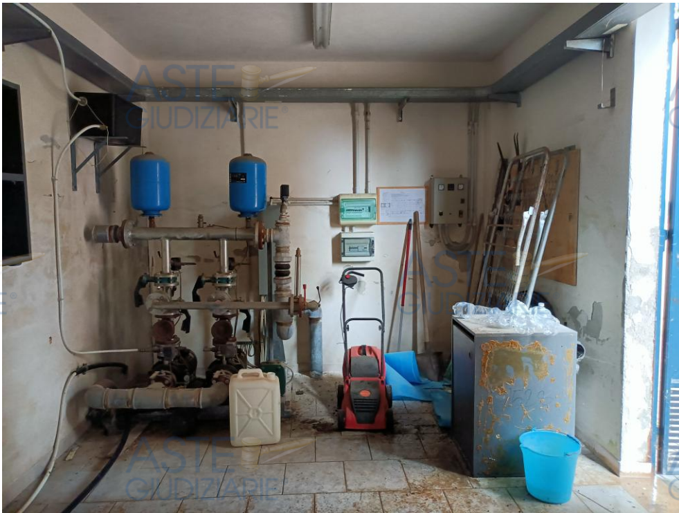
Foto n. 58 – Corpo G – Locale pompe.
