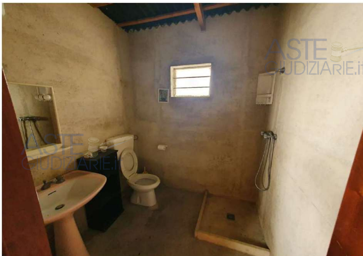
Foto 11 Lotto unico – Fabbricato abusivo e non censito particella 7 – vista interna bagno
