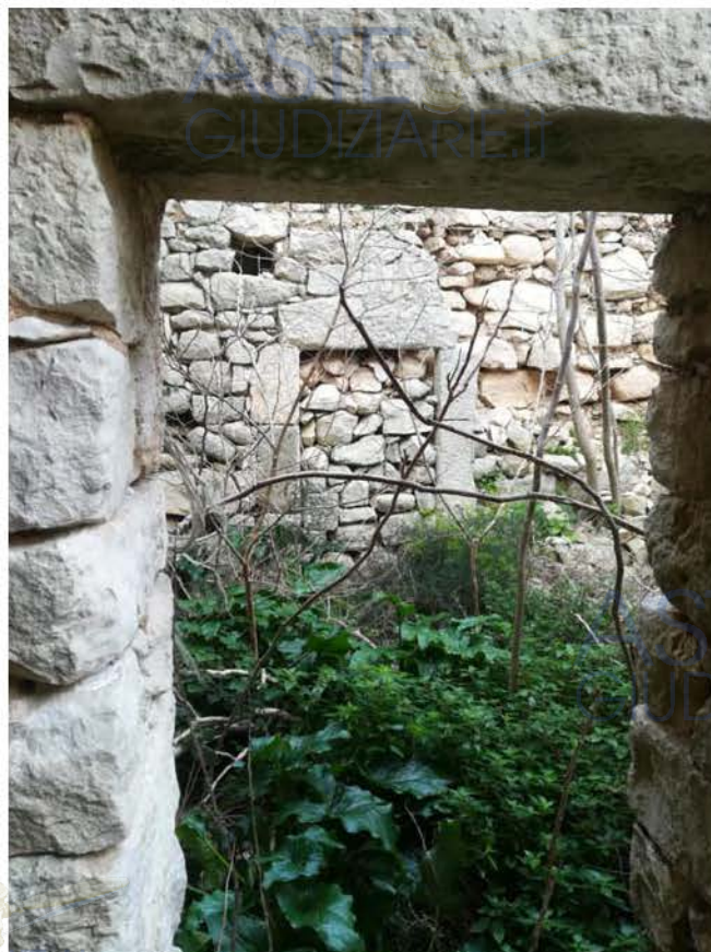
Foto 40 – particolare porta murata - p.lla 280 sub 1 fg 36 di Comiso – c.da Crocilla
