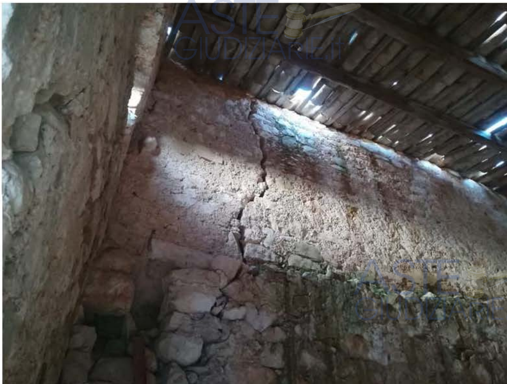
Foto 14 – interno b) particolare crepa e soffitto - p.lla 272 sub 1 fg 36 di Comiso – c.da Crocilla
