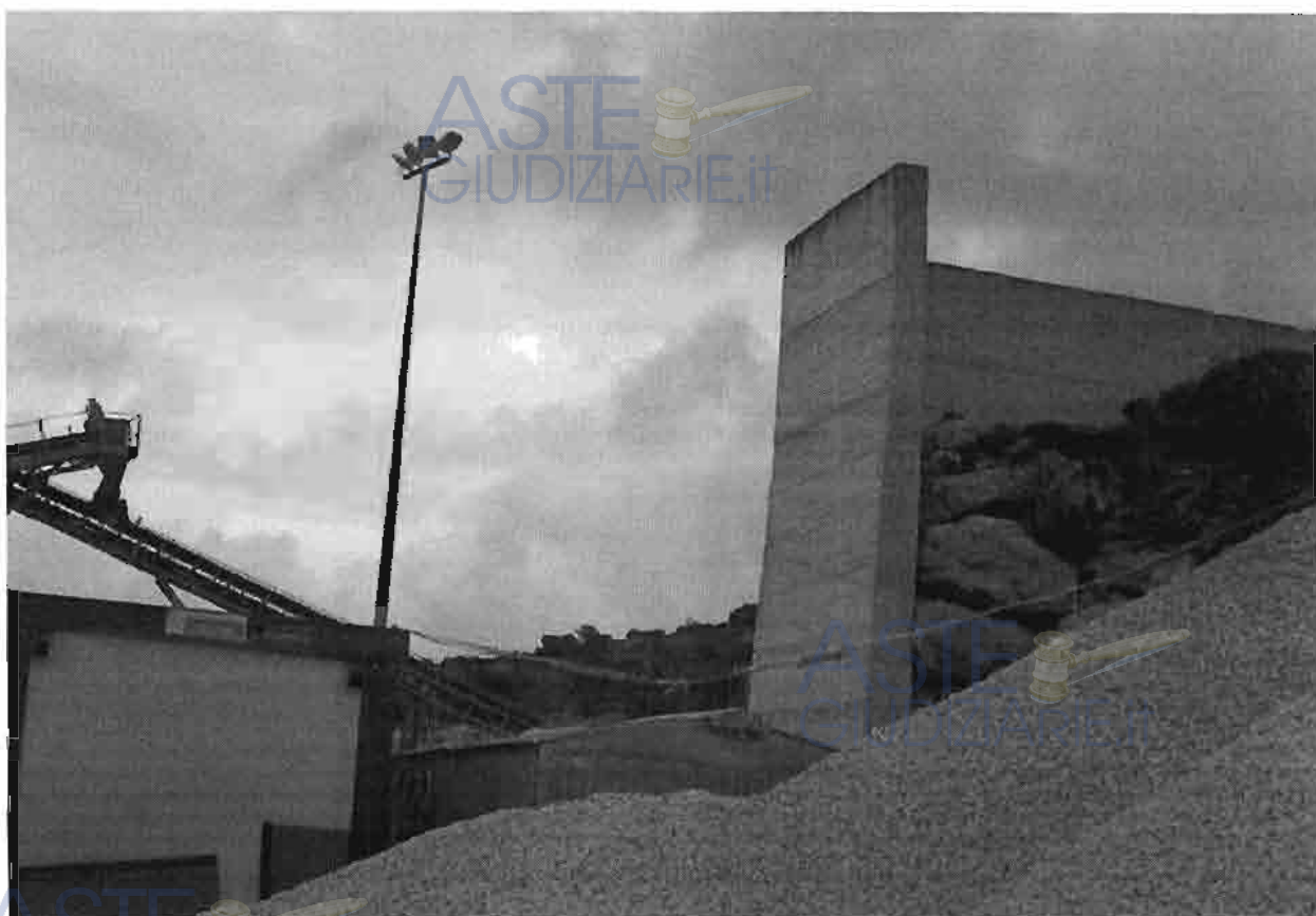
Struttura in c.a. per impianto di frantumazione muri di sostegno
