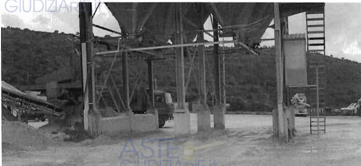
Struttura in c.a. per impianto di frantumazione piattaforme frantoio
