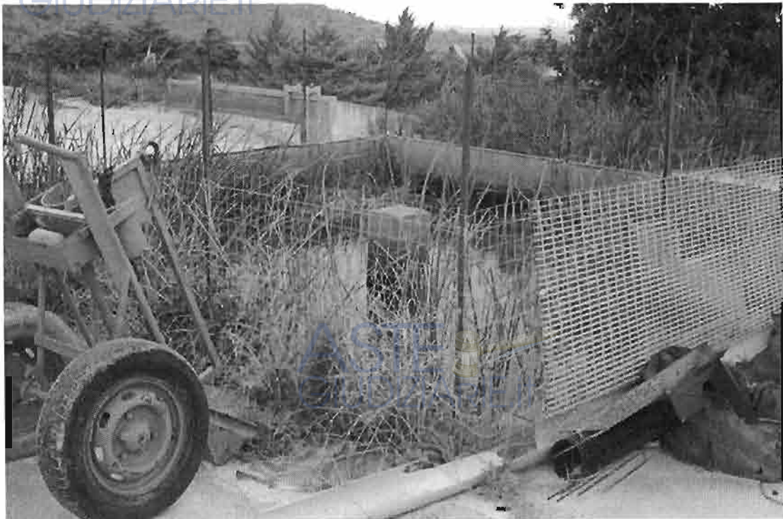
Vasca idrica interrata
