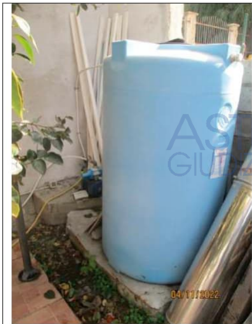
Foto 13. Particolare del sistema di raccolta acqua dell'impianto autoclave, a servizio dell'appartamento
