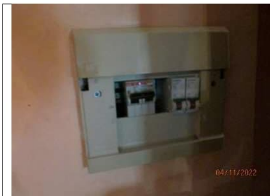
Foto 10. Particolare del quadro generale dell'impianto elettrico dell'appartamento
