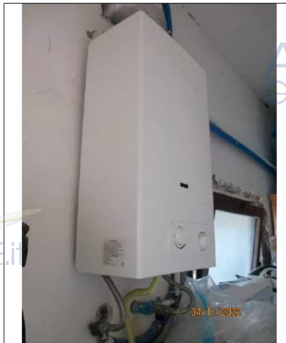
Foto 17. Vista del presente scaldino a gas per l'acqua calda sanitaria
