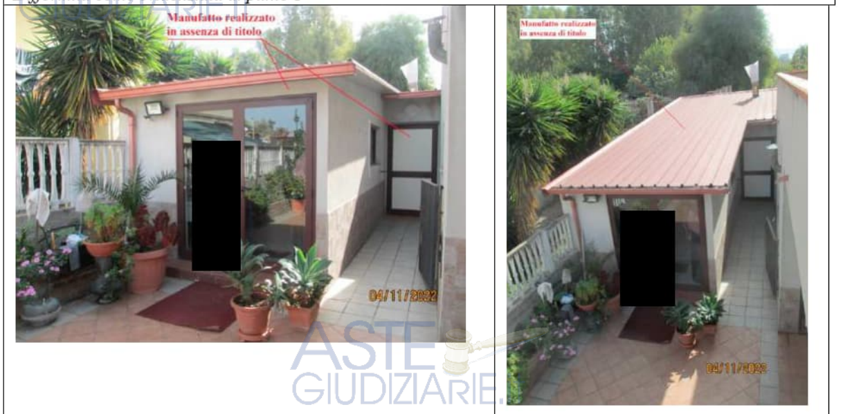
Diffformità come evidenziata al punto 2
