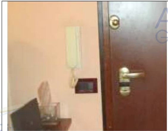
Foto 12. Vista del presente impianto citofonico
