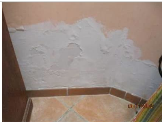
Foto 34. Particolare delle tracce di umidità di risalita presenti sulle pareti, in corrispondenza del pavimento
