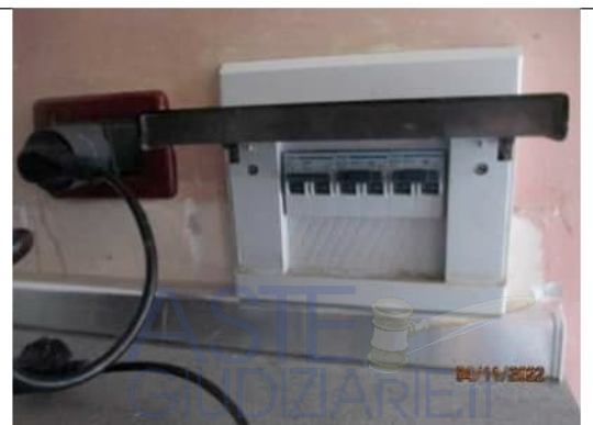
Foto 11. Particolare del quadro elettrico presente in cucina
