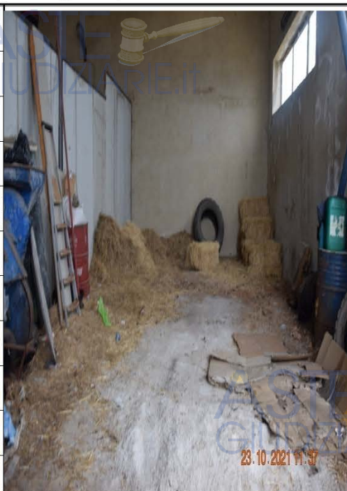
Piano T. - foto interna Deposito - Sub 2
