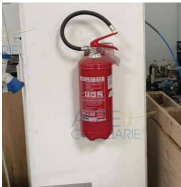
Estintore a parete
