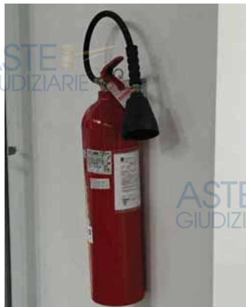
Estintore a parete
