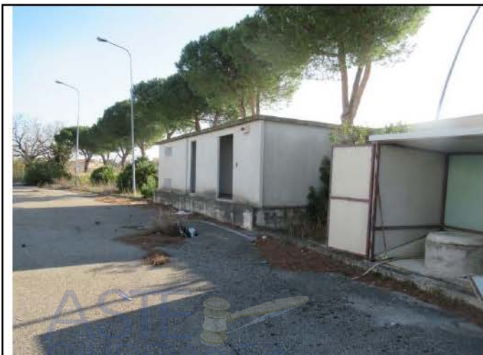
Foto 11 – Cabina ENEL Sub. 2
