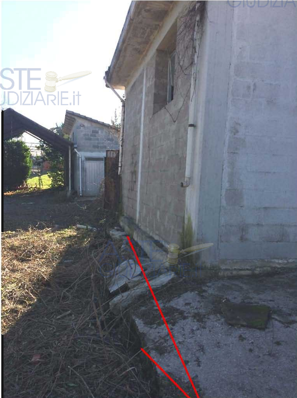
linea di frattura del cordolo di cemento a corona del prospetto anteriore
