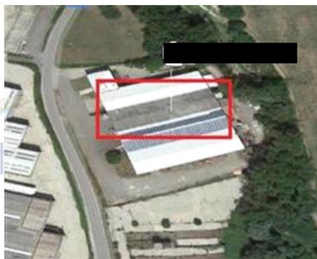
VISTA DALL'ALTO DELLA COPERTURA IN FIBRO-AMIANTO
