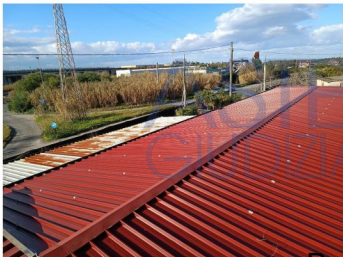
Foto 8: Catasto Terreni di San Ferdinando, foglio 17, particella 654 sub 4, Contrada Focoli. Lastrico solare sul quale è stata appoggiata una copertura a falde inclinate realizzata con struttura di ferro e coperture di lastre ondulate.
