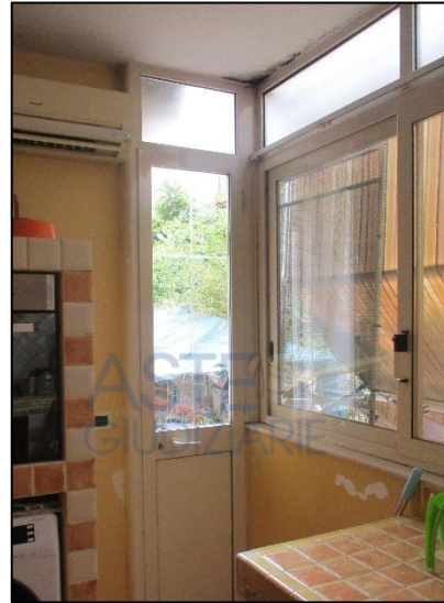
Foto 19 – tracce di umidità da condensa
