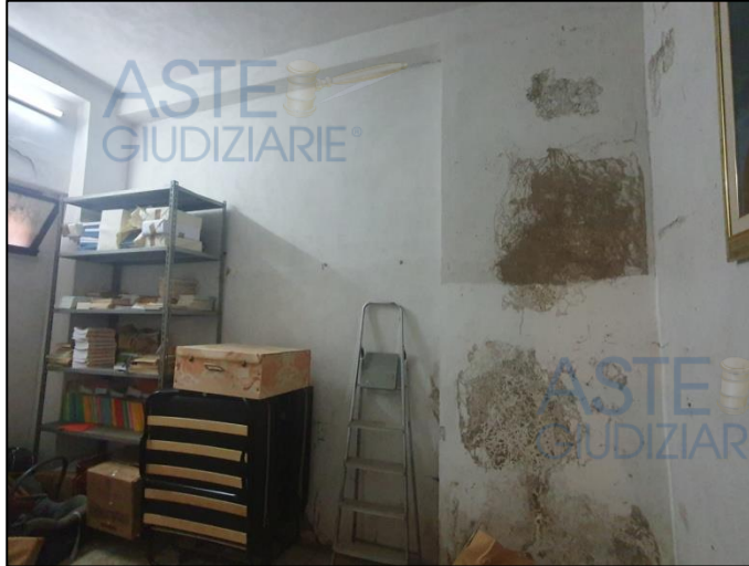
Foto 23– Tracce di infiltrazioni sul pilastro
