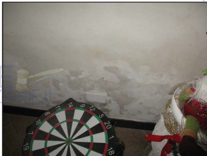
Foto 21 – tracce di umidità di risalita nel corridoio di disimpegno
