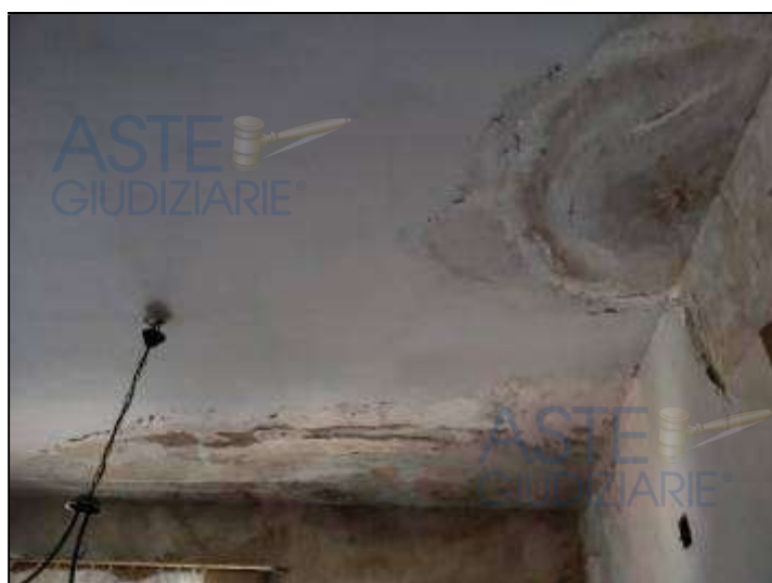
Infiltrazioni al primo piano del corpo B
