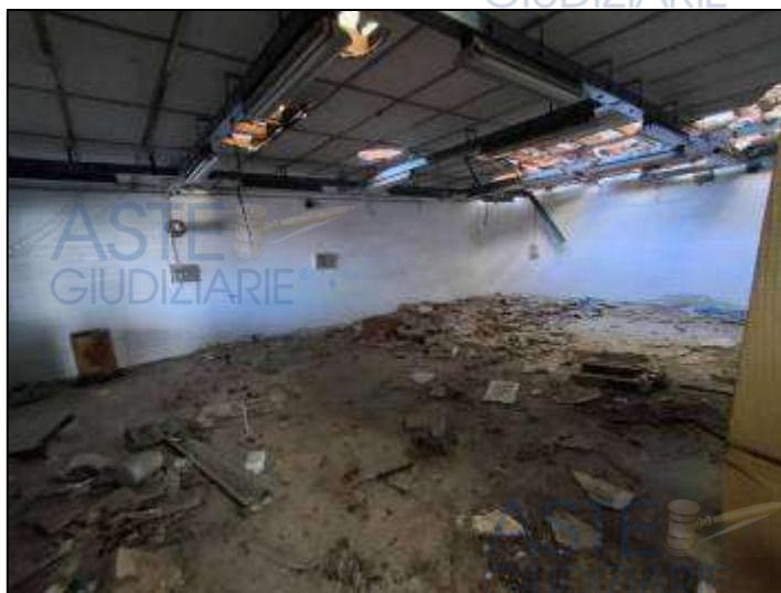
Sala di piano primo in parte priva di copertura
