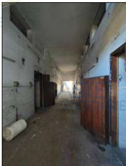
Corridoio di accesso alle celle frigorifere poste al piano terra
