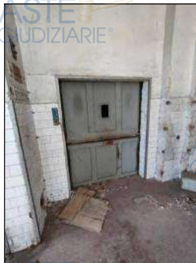
Montacarichi posto al piano terra
