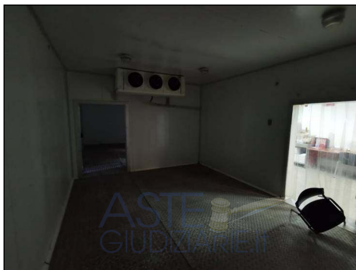
Cella frigorifera ubicata al primo piano (sub. 3)
