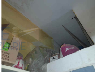
Foto 5 Infiltrazioni in corrispondenza dell'area wc
