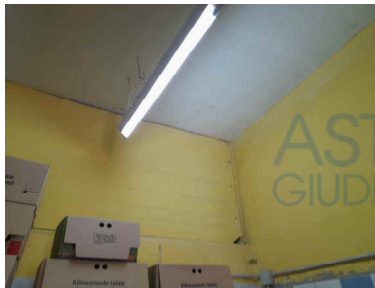
Foto 7 alone di infiltrazioni in corrispondenza dell'angolo in fondo a destra
