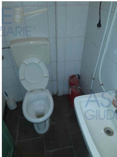
Foto 10 Wc con tubazione idrica a vista
