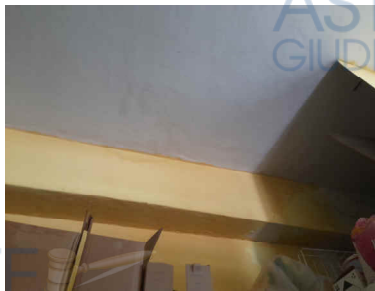
Foto 6 Infiltrazioni in corrispondenza dell'area wc – foto 2
