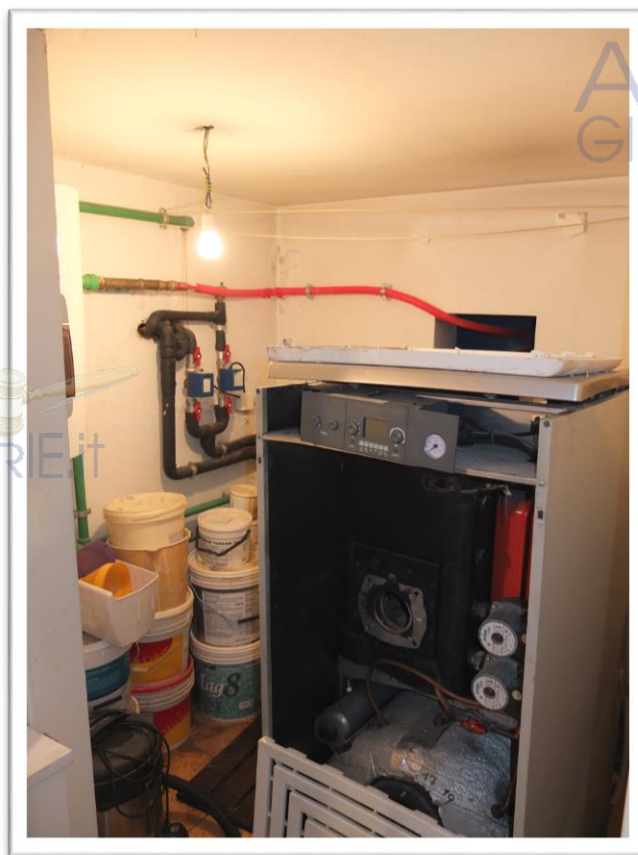
Locale Centrale Termica piano interrato
