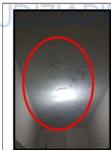
Foto n.24- w.c. -intonaco ammalorato
