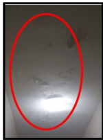
Foto n.24- w.c. -intonaco ammalorato evidenziato
