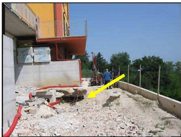
Foto 1 del 2009 evidenzia dei cedimenti già in atto
