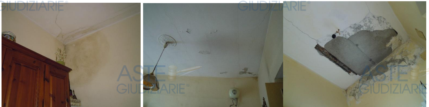
Fig. 13 Individuazione fotografica degli esterni dello stato reale dei luoghi dell'appartamento oggetto di pignoramento.
