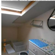
Foto n. 53 - Cartongesso a copertura delle macchie di umidità
