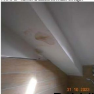
Foto n. 52 - Macchie di umidità del soffitto del bagno
