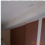
Foto n. 51 - Macchie di umidità del soffitto camera da letto
