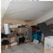
Foto n. 27 - Marchie di umidità nei spostigi
