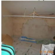
Foto n. 28 - Altre marchie di umidità nei spostigi
