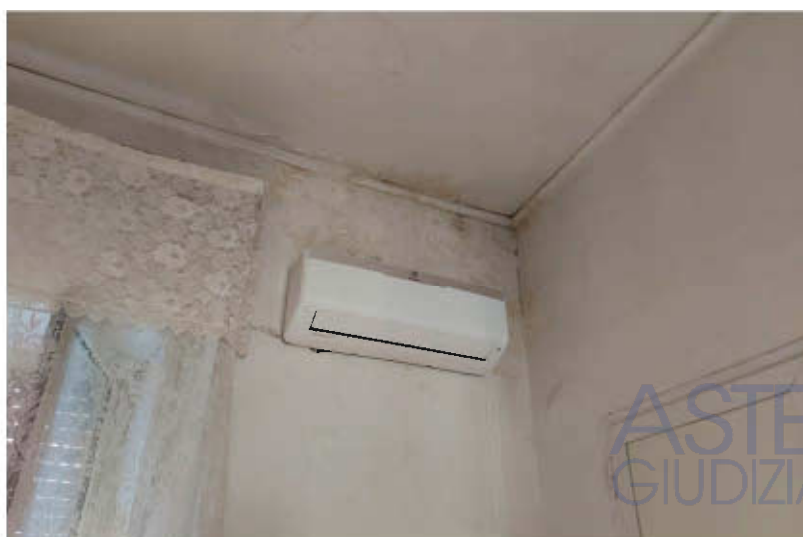
Camera L1 - part. zona interessata da infiltrazioni
