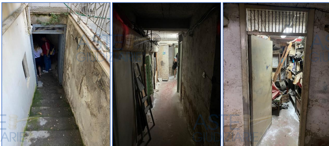
Figura 5. Rilievi fotografici cantinola.
