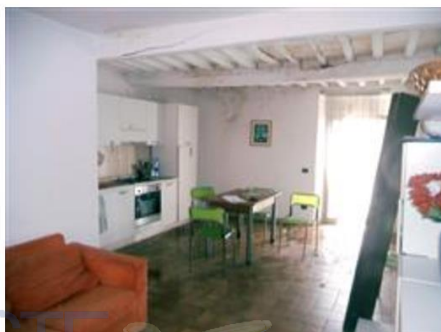
veduta della cucina-tinello al piano primo, con presenza di copiose infiltrazioni di acqua piovana dalla copertura; il trave di sostegno del solaio è crepato nella parte centrale
