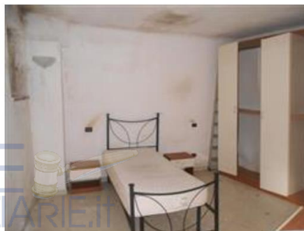
veduta della "cantina" impropriamente utilizzata come "camera", con finestre che si aprono sul retro del fabbricato, su proprietà di terzi: si notano le evidenti zone amuffite in corrispondenza della copertura e delle pareti.
