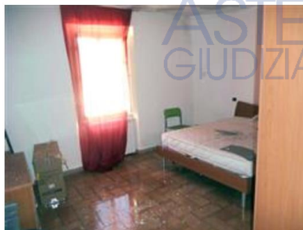
veduta della camera di maggiori dimensioni (lato via Roma) al piano secondo, con copiose infiltrazioni di acqua piovana dalla copertura
