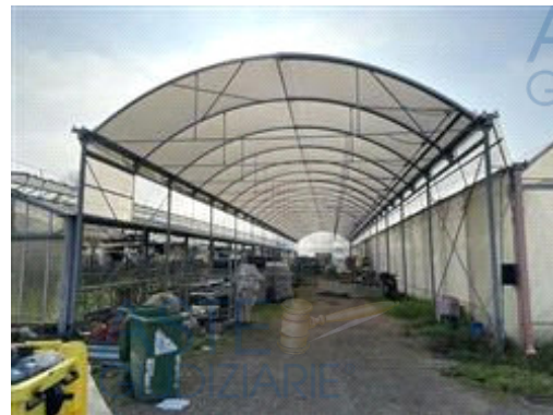
Collegamento serre fisse - serre mobili - Da regolarizzare e/o smantellare
