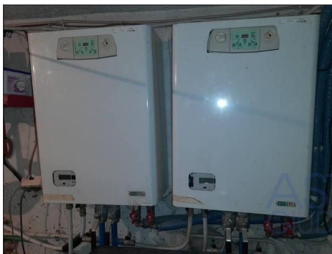
Foto 24 – Locale tecnico interrato sottostante l'appartamento - caldaia
