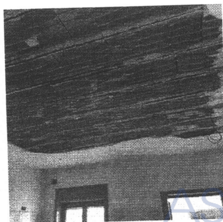
Sfondellamento solaio di copertura
