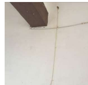
Cavo antenna, uscita dal muro
