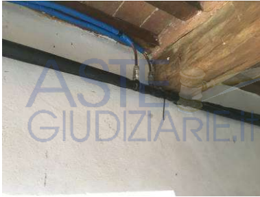
Tubazioni riscaldamento nei locali seminterrati
