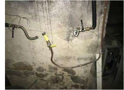
Attacchi caldaia nei locali seminterrati
