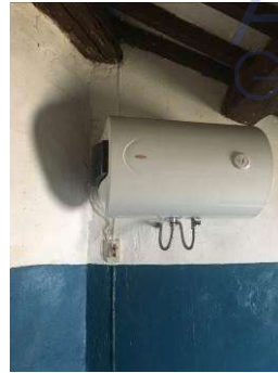
Boiler bagno piano primo
