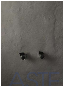
Attacchi Boiler bagno piano terra
