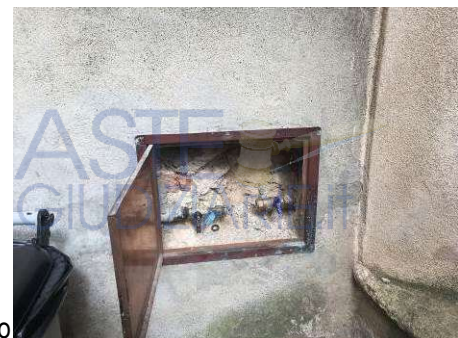
Vano contatore acquedotto
