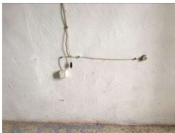
Impianto elettrico camera da letto
