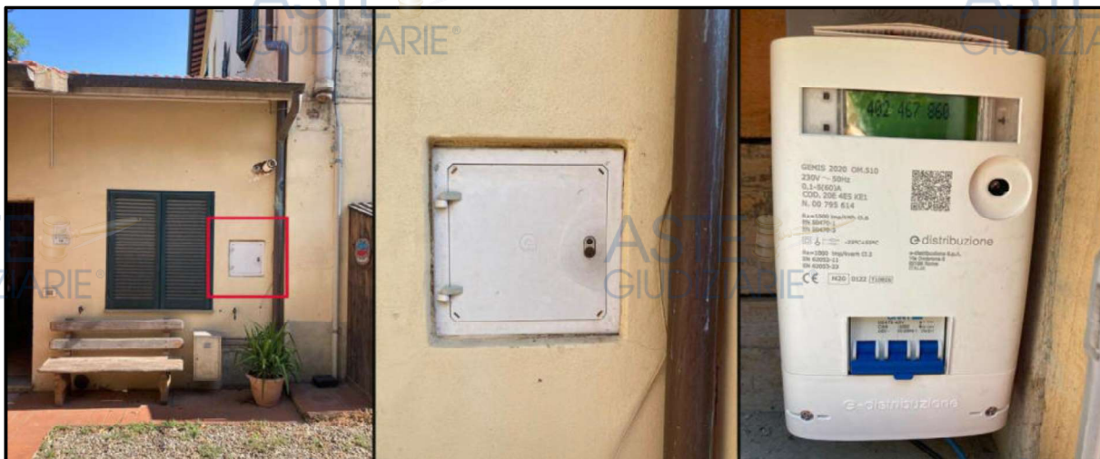
Impianto elettrico: punto di fornitura con alloggiamento contatore nella muratura esterna
