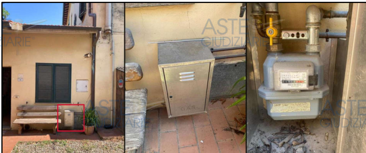
Impianto gas: contatore GPL nella pertinenza
