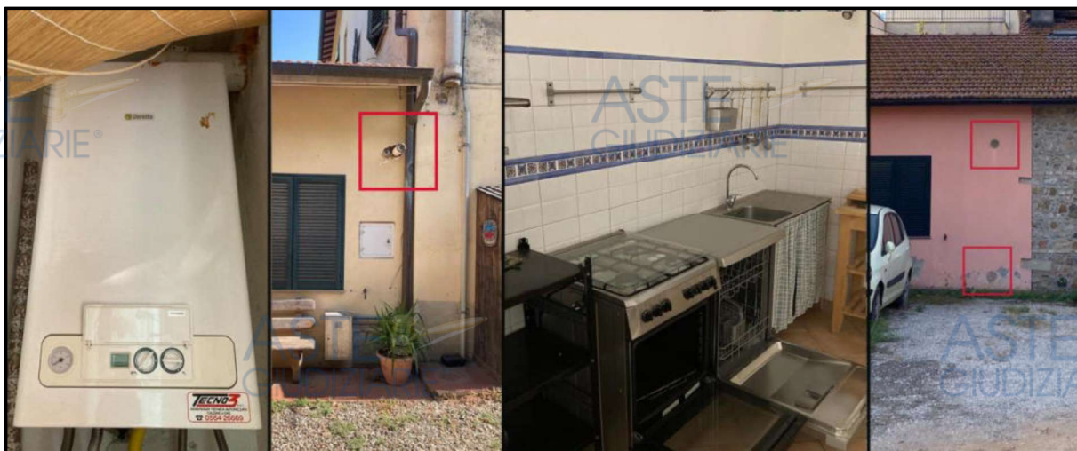
Impianto gas: caldaia con espulsione fumi, piano cottura, fori areazione e ventilazione.
