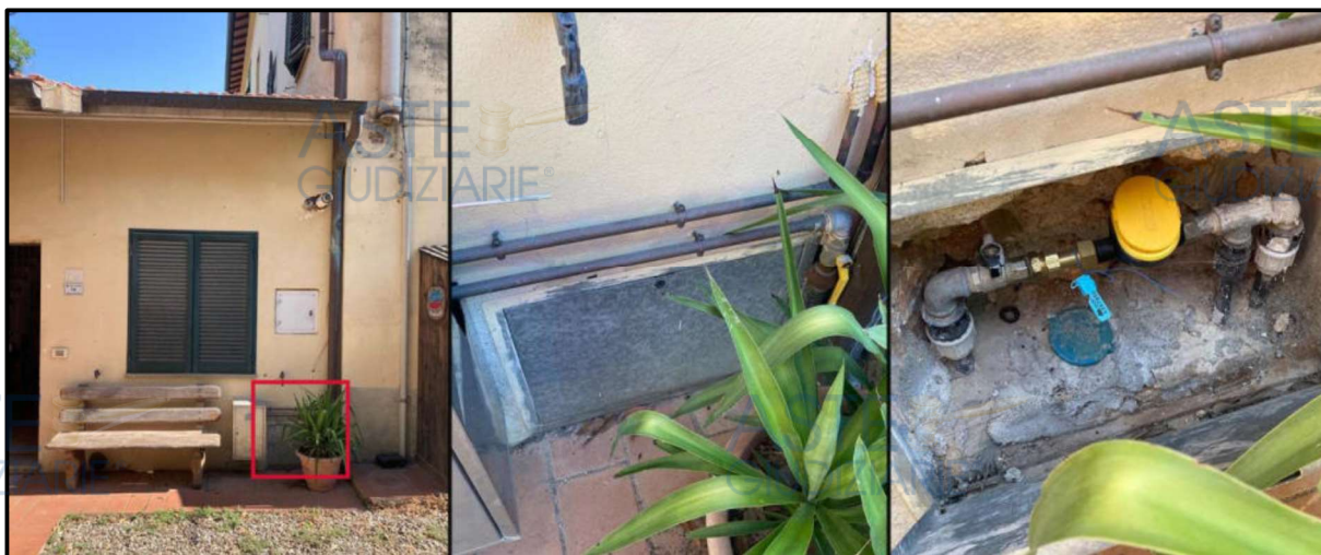
Impianto idrico: contatore in vano ricavato nella muratura esterna
