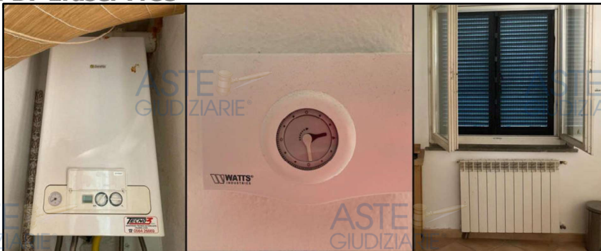
Impianto riscaldamento: caldaia, termostato, radiatore.
