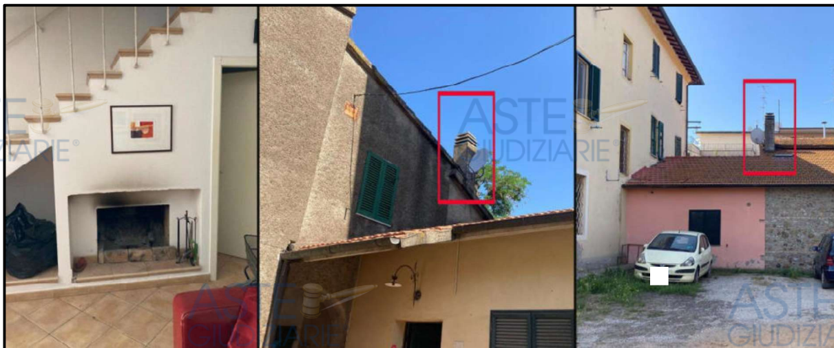
Impianto riscaldamento: camino tradizionale a legna e canna fumaria in copertura
