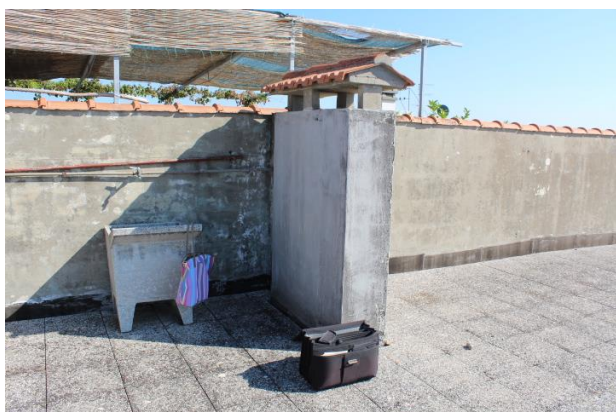
PARTICOLARE DEL RUBINETTO ACQUA E CANNA FUMARIA e MURATURA DI DIVISIONE A SUD
