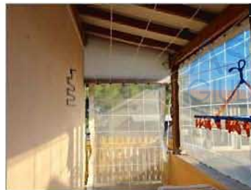
FOTO 50 - VERANDA CHIUSA NON CONFORME
