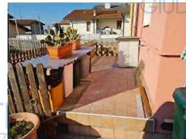
FOTO 30 - BALCONE NON CONFORME SUL FRONTE RETROSTANTE
