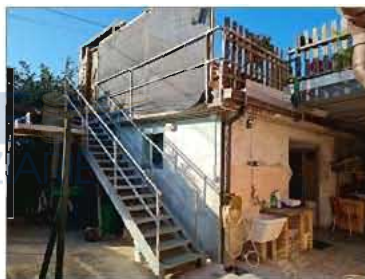
FOTO 17 - SERVIZIO NEL RETRO CON TERRAZZO NON CONFORME COPERTURA
