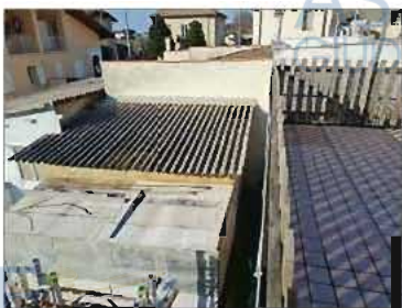
FOTO 26 - TAMPONAMENTI TETTOIE A PIANO TERRA NON CONFORMI
