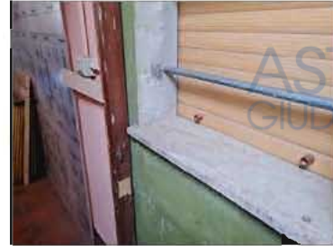
FOTO 66 - DETTAGLIO INTERNO TETTOIA NON CONFORME SUL RETRO
