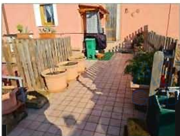
FOTO 20 - TERRAZZO NON CONFORME DI COLLEGAMENTO A PIANO PRIMO
