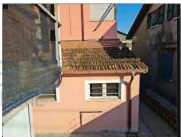
FOTO 19 - VISTA AMPLIAMENTO A PIANO TERRA NON CONFORME
