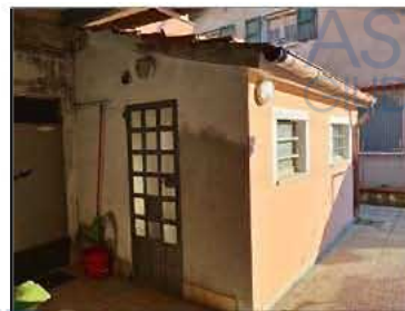
FOTO 24 - AMPLIAMENTO A PIANO TERRA NON CONFORME
