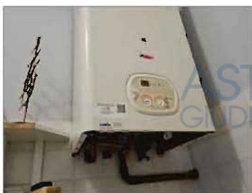
FOTO 70 - CALDAIA PIANO PRIMO
