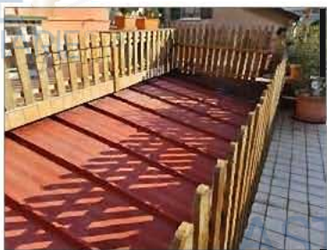
FOTO 25 - COPERTURE TETTOIE A PIANO TERRA NON CONFORMI
