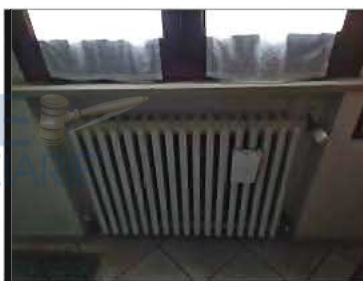
FOTO 71 - PIANO TERRA RADIATORE IN NICCHIA SOTTO FINESTRA
