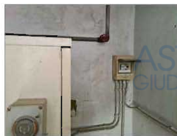
FOTO 72 - CALDAIA PIANO TERRA
