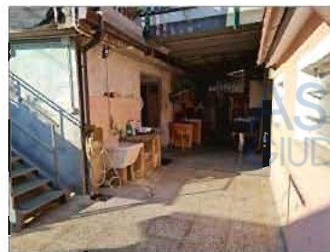
FOTO 18 - TETTOIA NON CONFORME CON TERRAZZO DI COLLEGAMENTO
