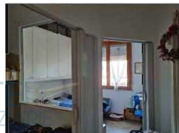
FOTO 54 - PIANO PRIMO CAMERA CON SUDDIVISIONE NON CONFORME
