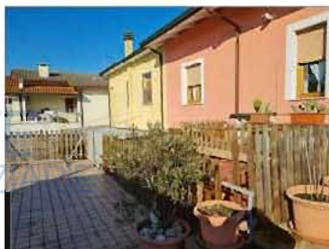
FOTO 21 - TERRAZZO E COPERTURE TETTOIE NON CONFORMI
