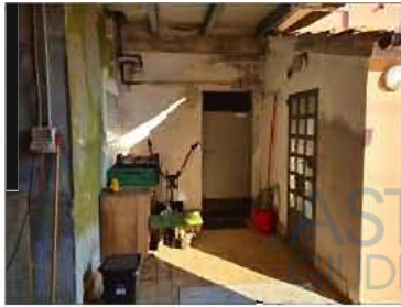
FOTO 31 - CENTRALE TERMICA A PIANO TERRA
