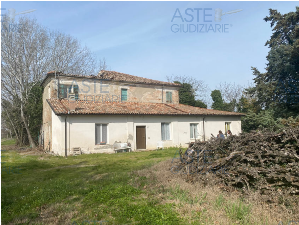
Fot. 13 - Foto del fabbricato oggi. In evidenza il crollo della copertura nella parte sinistra.
