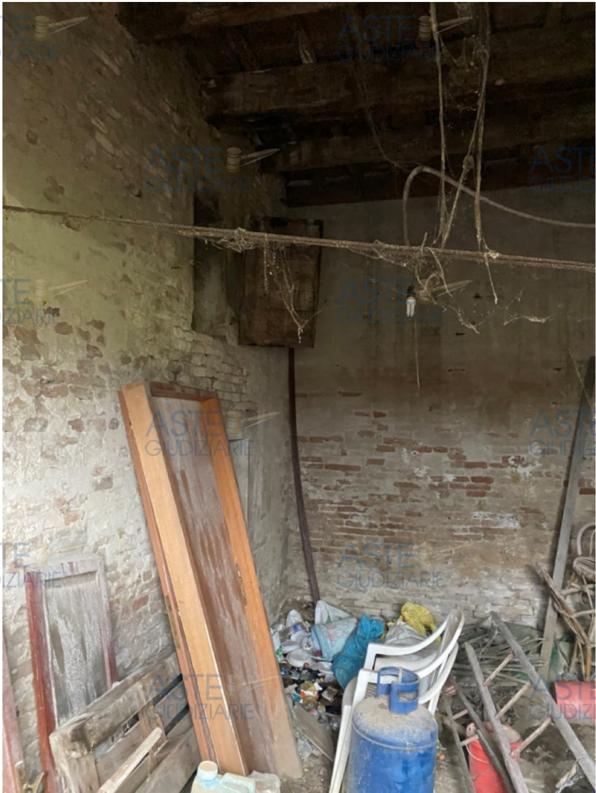
Fot. 17 - Scorcio degli interni del fabbricato colonico. In evidenza lo stato di abbandono ed il deterioramento delle strutture portante.
