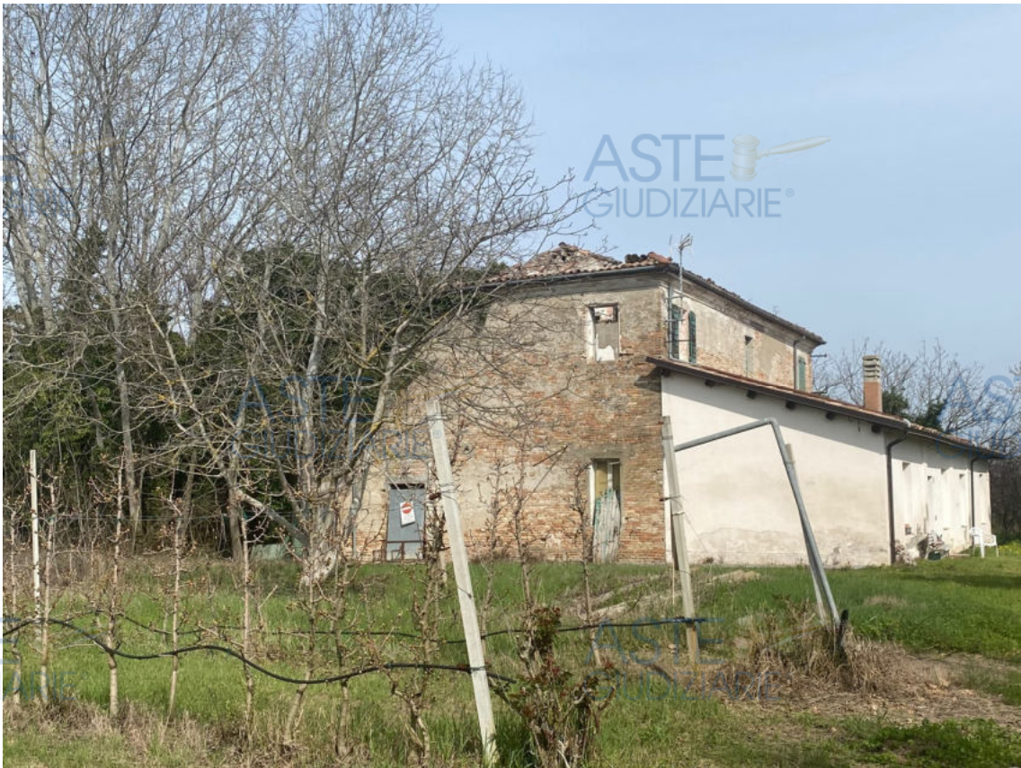
Fot. 14 - Foto laterale del fabbricato oggi. In evidenza il degrado strutturale dell'edificio.
