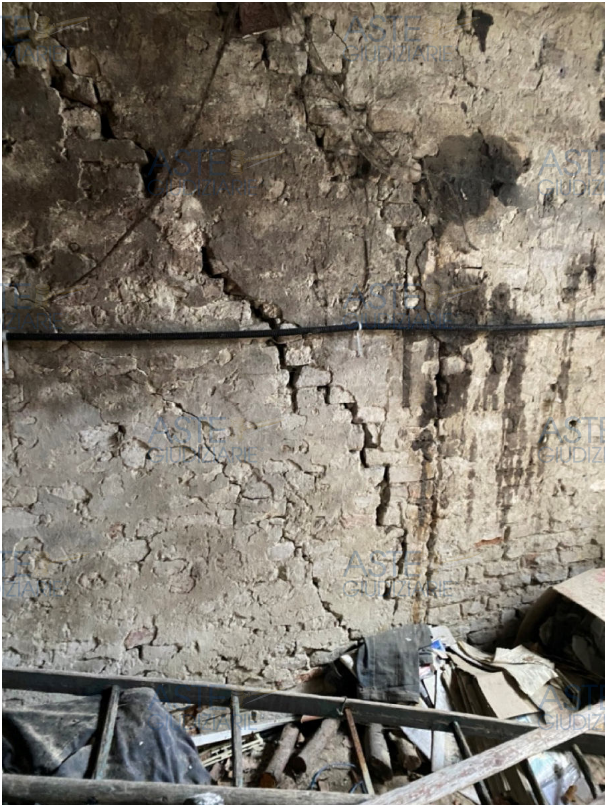
Fot. 18 - Foto del muro interno portante. In evidenza una preoccupante crepa strutturale a 45 gradi dovuta al cedimento strutturale del muro stesso dovuta da sovraccarico e da cedimento del terreno.
